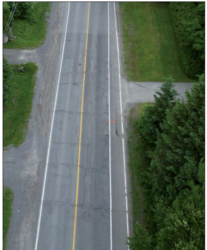
Figure 5 : Exemple d'une chaussée endommagée par les effets du trafic
